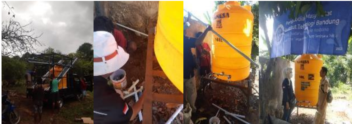
Gambar 5. Proses Pengadaan Air Bersih Dusun Poni, Desa Tuafanu (Sumber: Dokumentasi peneliti, 2022)
