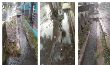
Gambar 7. Kondisi Titik Saluran Drainase A2, A4, dan A5
